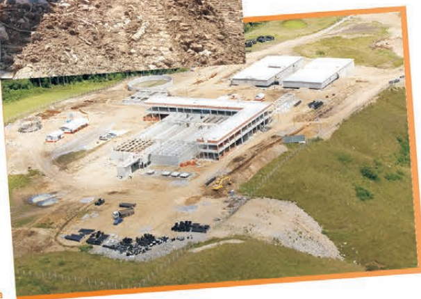
Estação de Tratamento de Água
